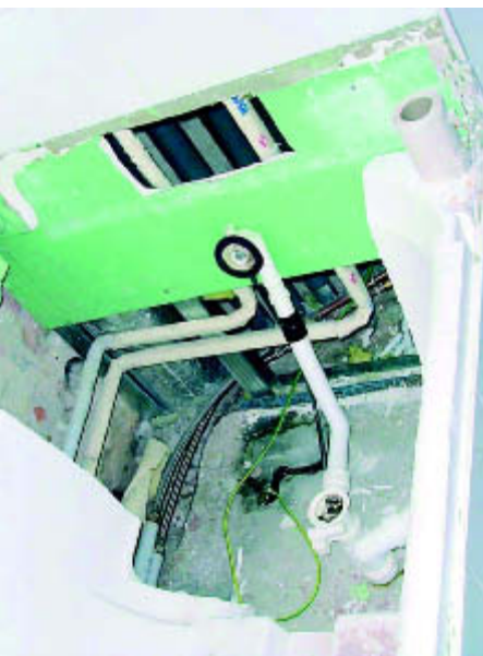
■ Schlauchleitung, außer als Armaturenanschluss nicht zulässig.
