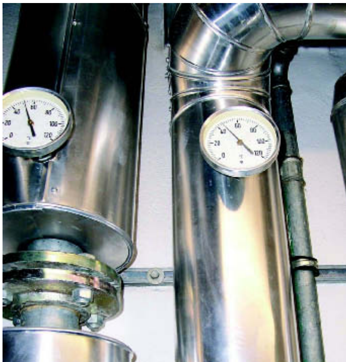
■ Warmwasser- und Zirkulationstemperaturen im unzulässigen Bereich.
